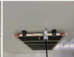
Abbildung 4: Detailsicht elektrischer Anschluss
